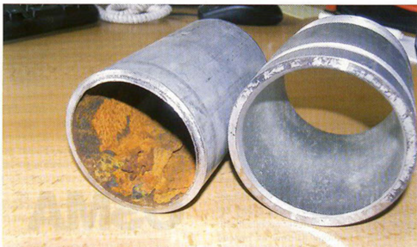
Ukážka potrubia po dvoch rokoch od ukončenia kolaudácie – rozvody neboli v prevádzke ani dva roky
