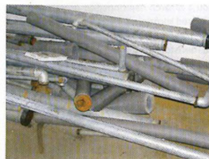
Rozvod studenej a teplej vody + cirkulácie z pozinkovaného potrubia po 3,5 rokoch prevádzky
